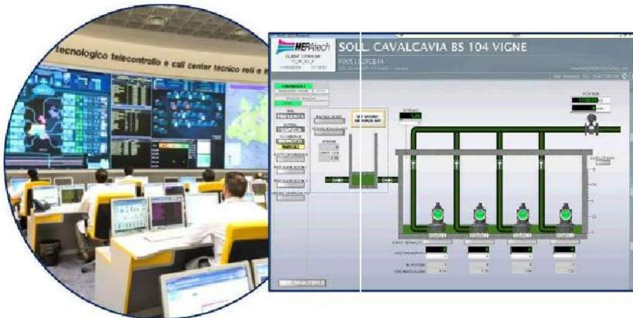
Figura 22 - Sala di telecontrollo di Forlì e schermata esemplificativa del software in uso
